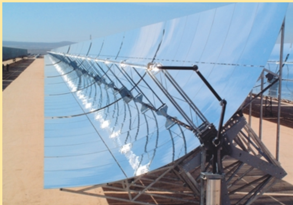
Solarthermisches Großkraftwerk mit Parabolrinnen-Technologie, Spanien
